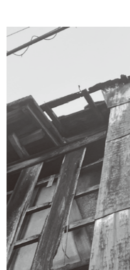
危険な空き家の外壁
